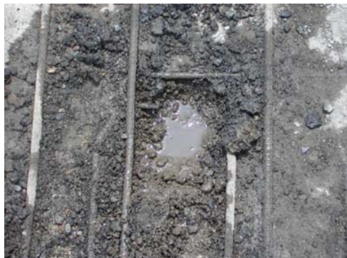
写真-4 床版内の滞水状況
