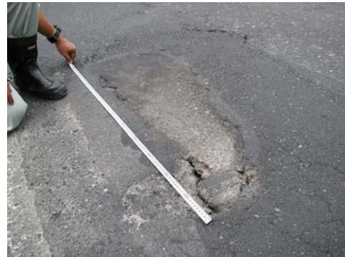
写真-2 舗装路面のポットホール
