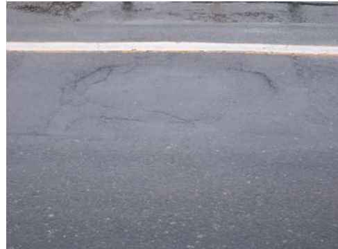
写真-1 舗装路面の変状
