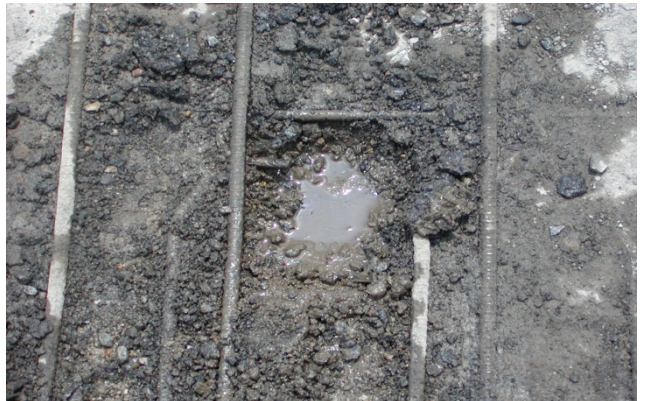
写真-4 床版内の滞水状況
