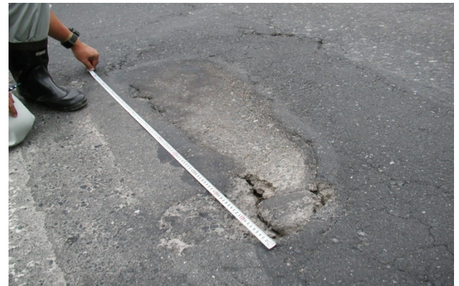
写真-2 舗装路面のポットホール
