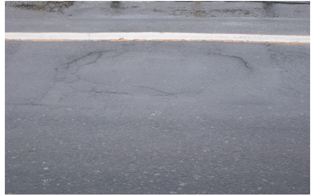
写真-1 舗装路面の変状
